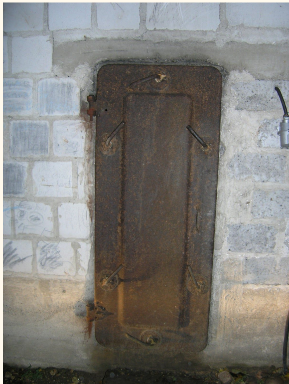
Gazoszczelne drzwi wewnętrzne zamontowane w oborze. Fot. J. Kulak
