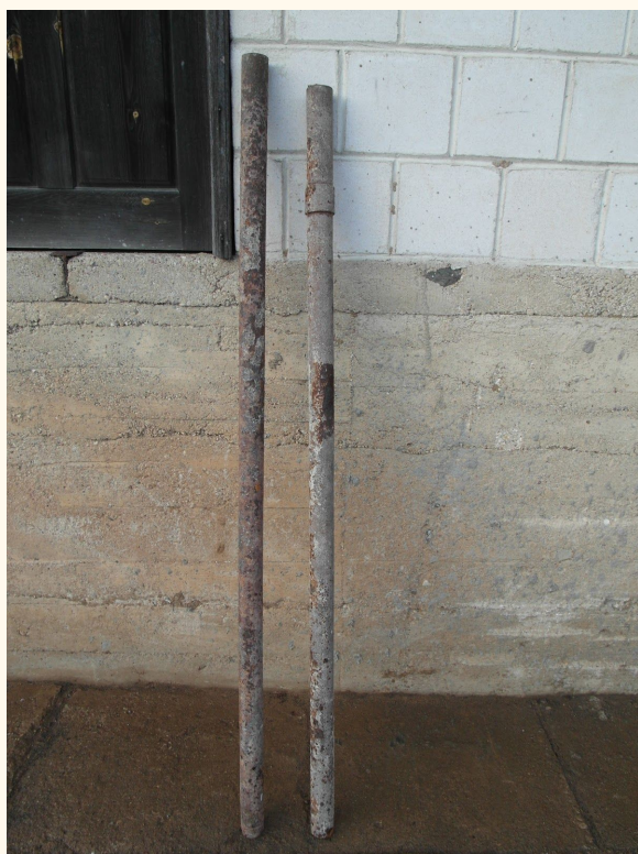
Fragmenty rur zasilających betoniarnię w wodę.
