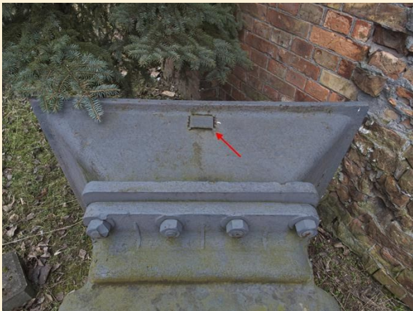
Pancerz NPS-3 z lokalizacją tabliczki wskazującej poprawny kierunek montażu. Po zabetonowaniu panczerza oznaczenie było przykryte betonem. Fot. P.Tymiński
