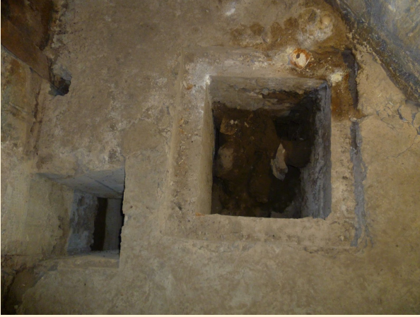
Zasypany zbiornik zrzutni tusek. Fot. J.Kułak
