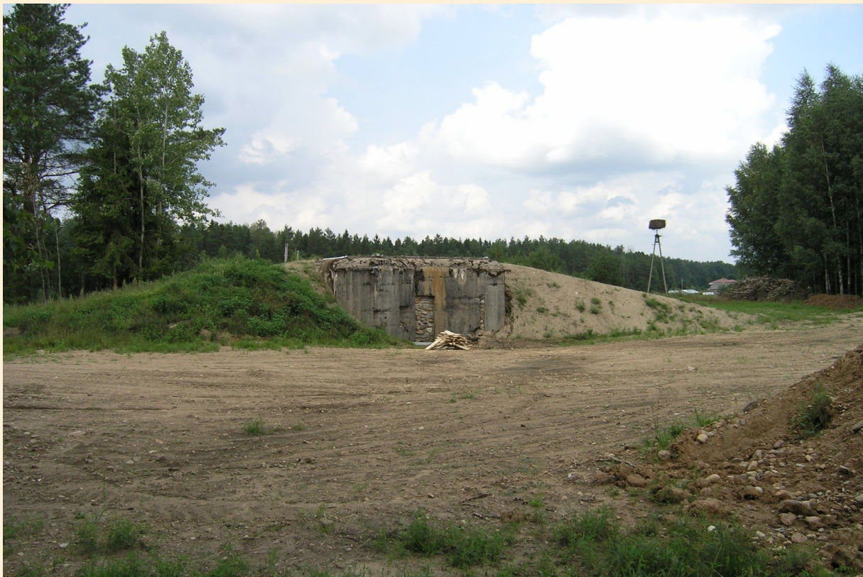
Widok na schron po wykonaniu obsypów. W głębi widoczna sterta korzeni. Fot. J.Kulak.
