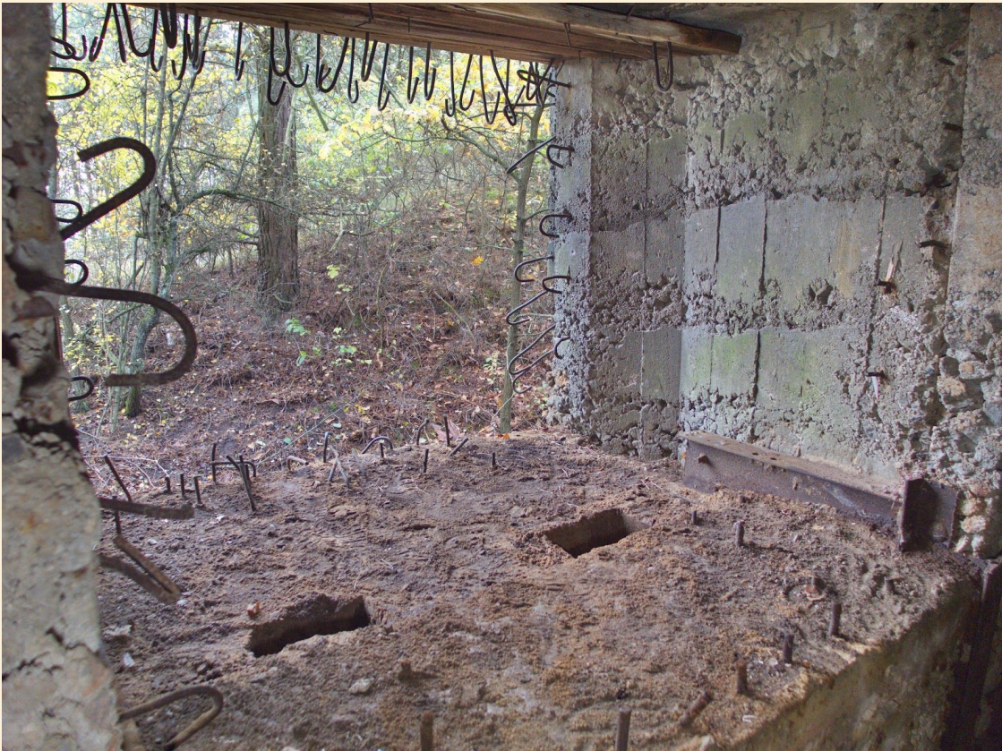
Otwór technologiczny pozostawiony w celu późniejszego osadzenia pancerza skrzyniowego zestawu DOT-4. Fot. P. Tymiński
