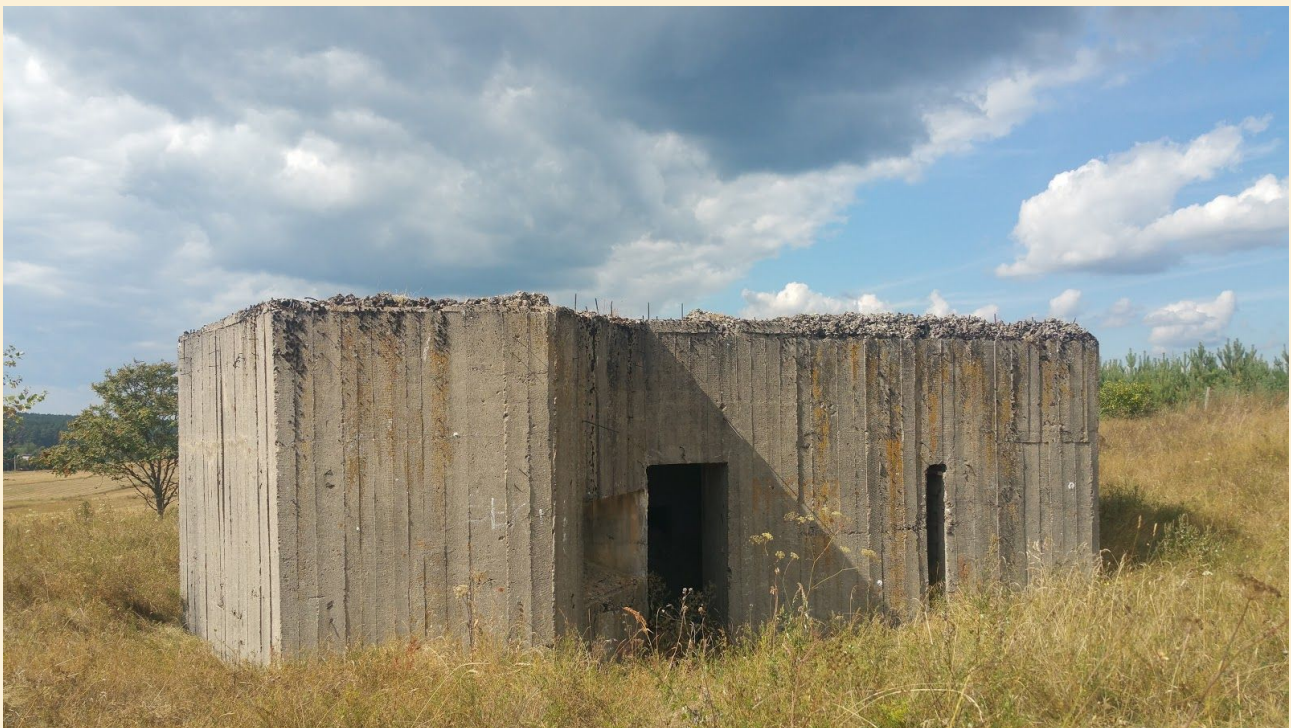
OPDOT 68-MR-03 z niewybetonowanym stropem. Fot. P. Tymiński
